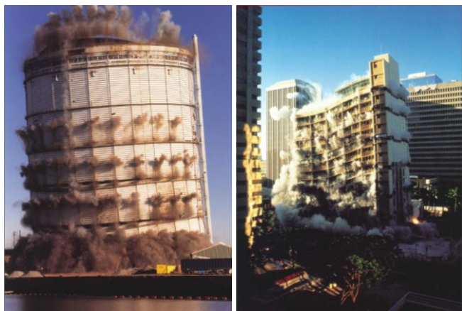
Rys. 36. Controlled demolition wielkiego zbiornika (na lewo) i wysokiego budynku (na prawo). Poszczególne ładunki odpalane są w ściśle zaprojektowanej sekwencji czasowej [24].
